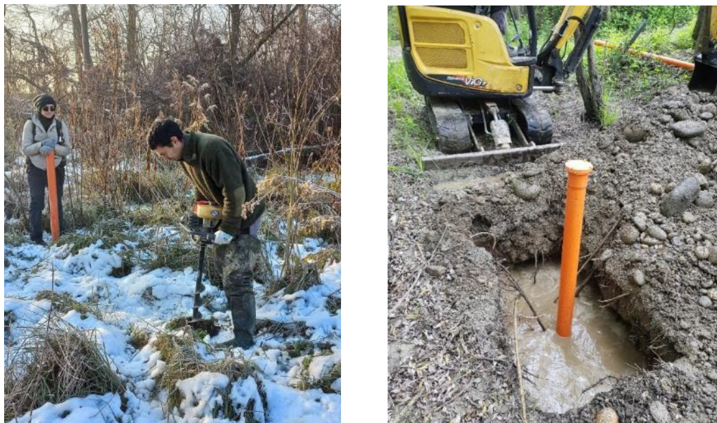
Figura 14: Esempi di installazione dei piezometri mediante scavo con mototrivella (a sinistra) e miniescavatore (a destra).
